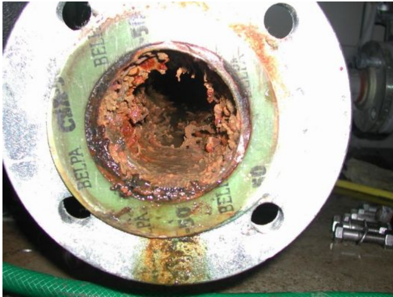
Folgen mangelhafter Instandhaltung
